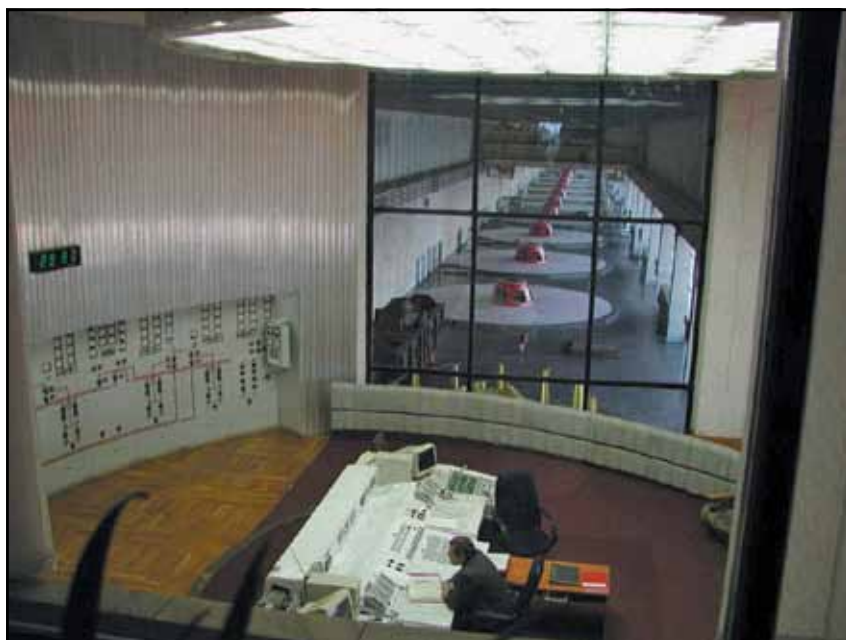
Центральный пульт управления машинного зала Усть-Илимской ГЭС
