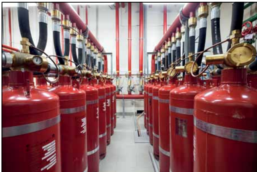
Система газового пожаротушения
