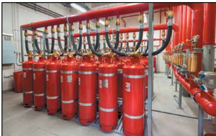
Система газового пожаротушения
