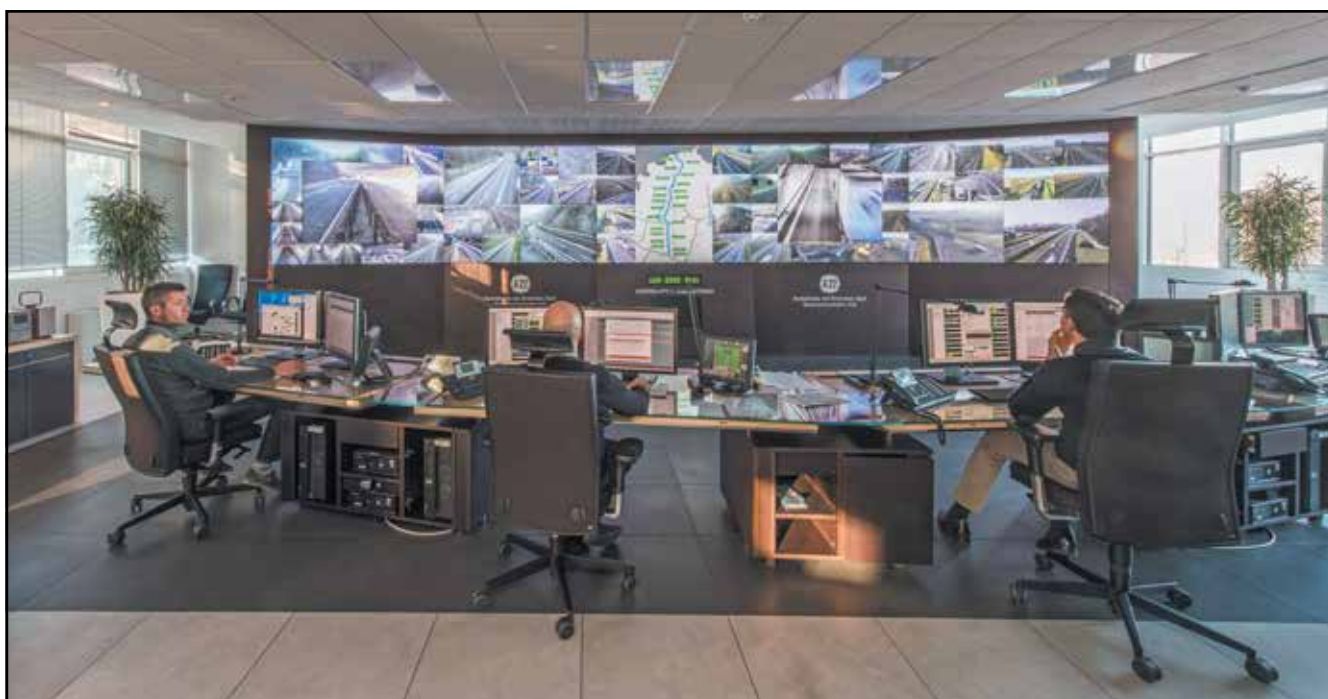
Полностью интегрированное и объединенное в сеть оборудование позволяет улучшить процесс управления дорожным движением
