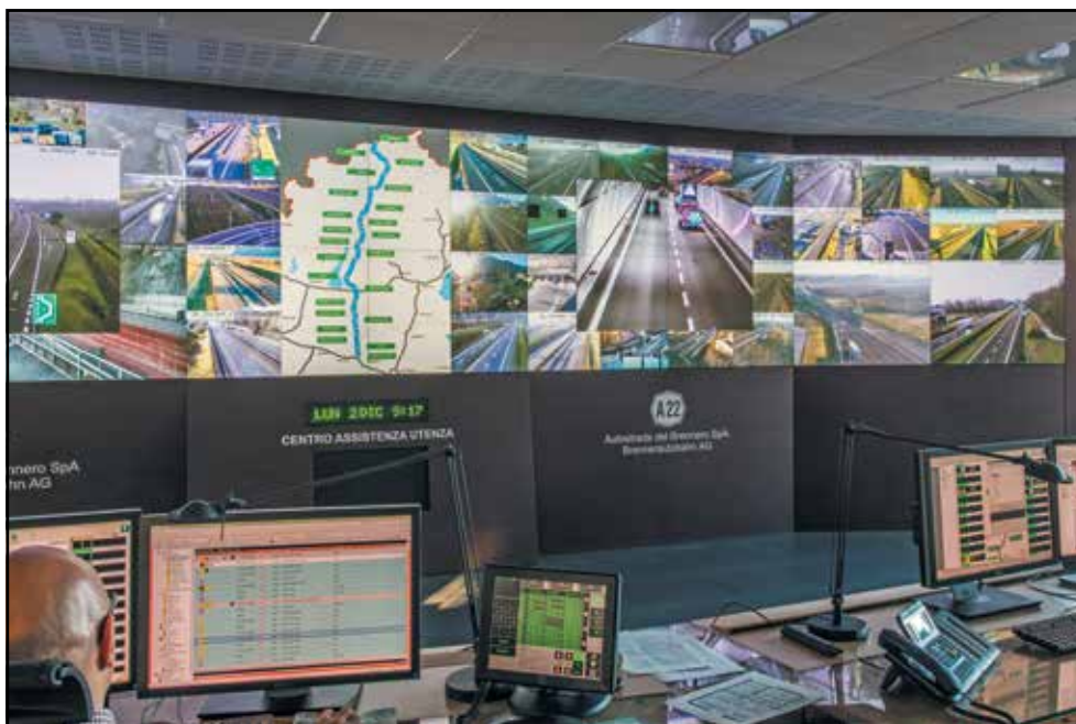
Видеостена из светодиодных кубов Mitsubishi позволила повысить эффективность системы отображения в одном из центров управления дорожным движением в Италии
