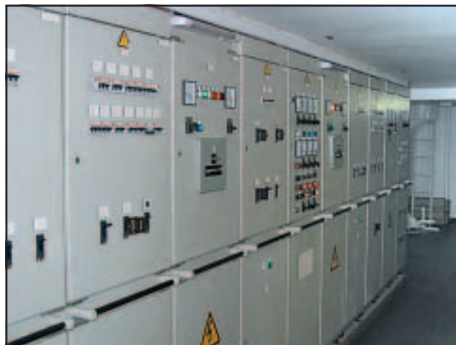
Главный распределительный щит
